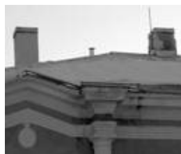
Vääna mõisa sobimatult taastatud korstnapits ühes inetu „mütsiga“. (Fotod: J. Vali)
